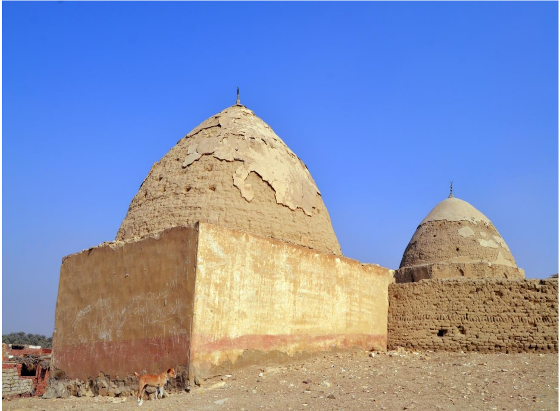
لوحة (١) الجدار الجنوبي و الجدار الغربي لمسجد موسى و يظهر به قبتي الدفن الملحقتين بالمسجد.
