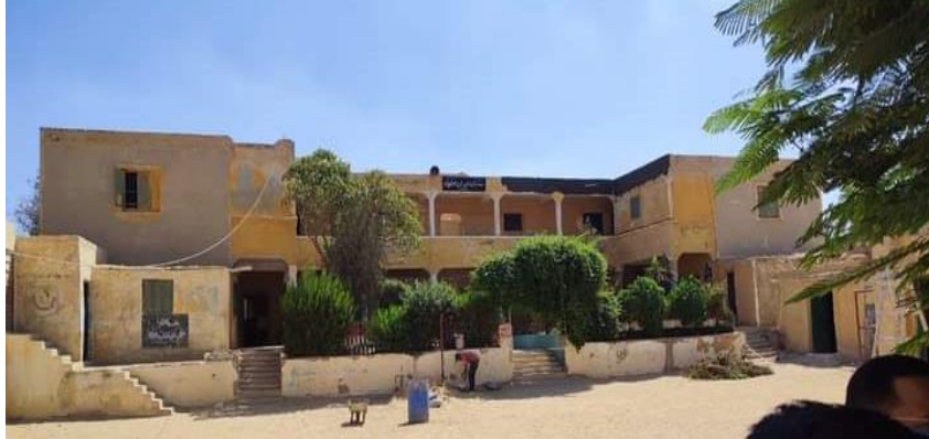
صورة (٢٢) مدرسة تحتاج إلى إعادة بناء بقرية الخطاطبة المحطة
