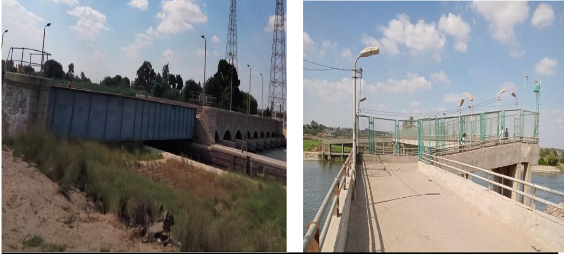
صورة (١٤) كوبري مشاة يربط بين الأخماس والأخماس غرب والعزب صورة (١٥) قناطر تستعمل أيضا كوبري مشاة بين الجيار والعزب التابعة لها
